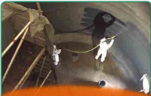
Silos und Behälter
