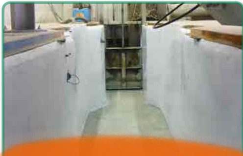
Kläranlagen und Kanäle
